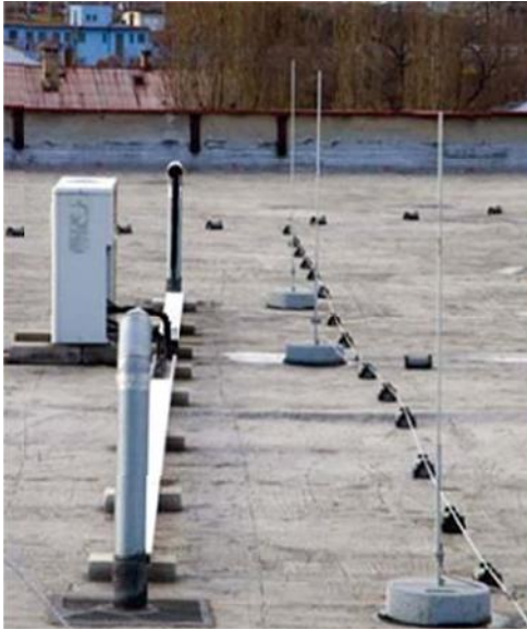
Obr. 5 Správna ochrana na vy nievajúcej nadstavbe na streche objektu použitím oddialeného izolovaného bleskozvodu vytvoreného zo zachytávacích tyčí
