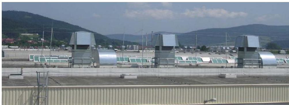
Obr. 4 Správne realizovaná ochrana vzduchotechnických zariadení na streche objektu
