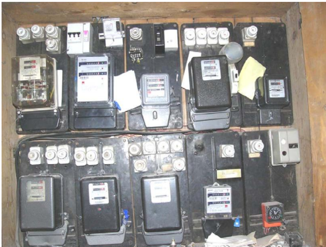
Obr. 1 Chybný spôsob inštalácie elektromerov (dokumentácie) v rozvádzačoch
